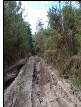
Sol non porteur détruit par le passage répété d'engins de débardage
